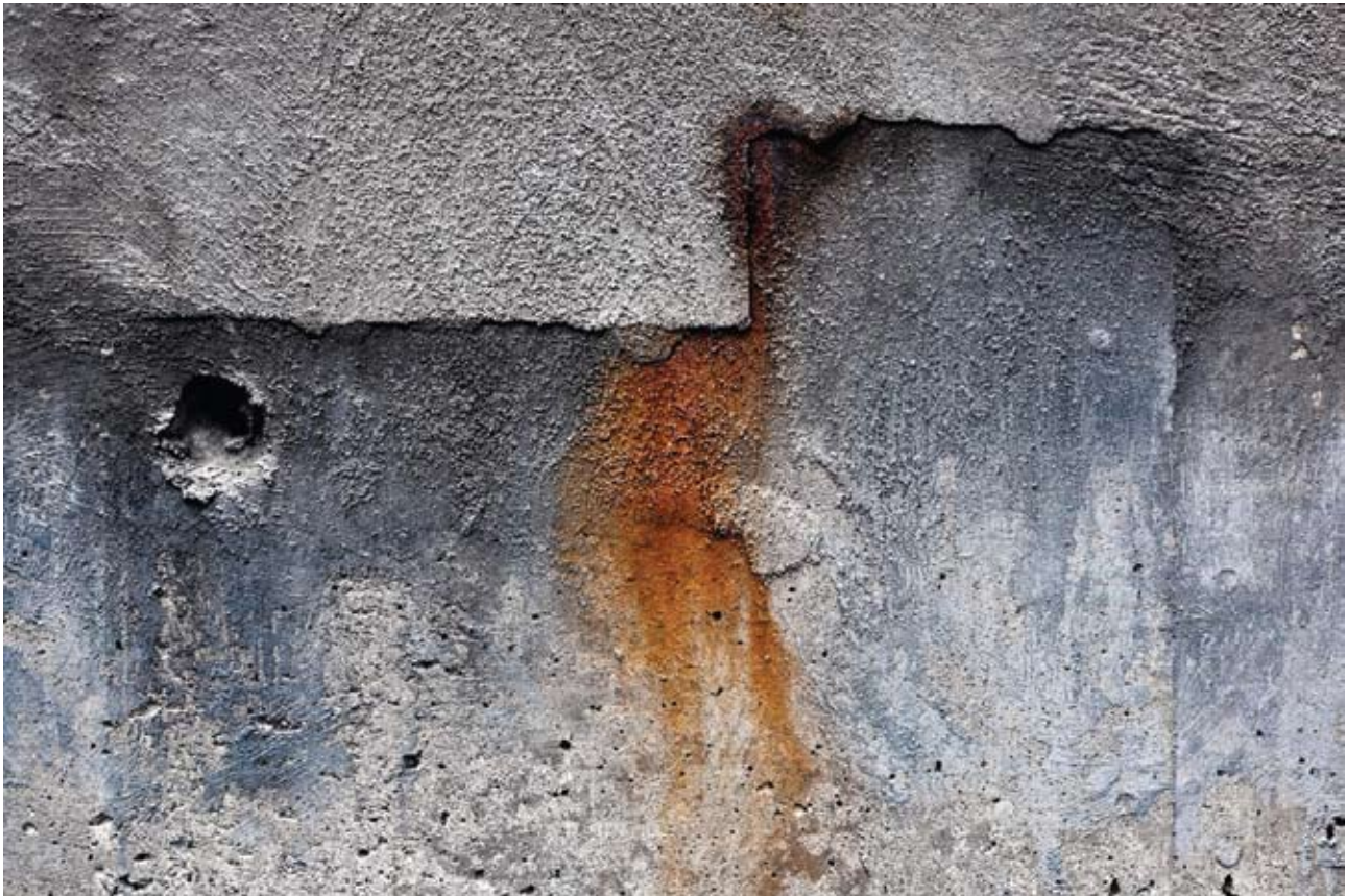
כך נראה קיר בטון שנפגע מרטיבות: המים חדרו אל תוך הבטון, גרמו לקורוזיה בברזל הזיון שהחלה לפורר את הקיר
